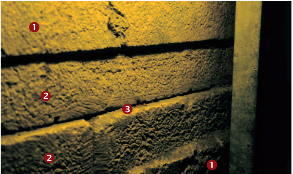
Abb. 157 Im Westmauer-Tunnel: Die erste und die zweite Bausteinlage. Der zweite Baustein wurde um ca. 2 cm zurückgezogen, um die Mauer leicht schief zu bauen, damit sie dem Beobachter auf der an ihr entlanglaufenden Straße in der beruhigenden Illusion gerade erscheinen sollte.
